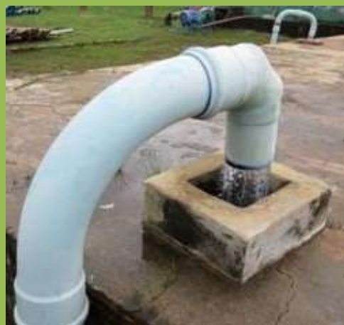
Foto 135 - Reservatório de água- captação por poços tubulares (Aquífero Solimões/Cruzeiro do Sul) - DEPASA, Cruzeiro do Sul.
