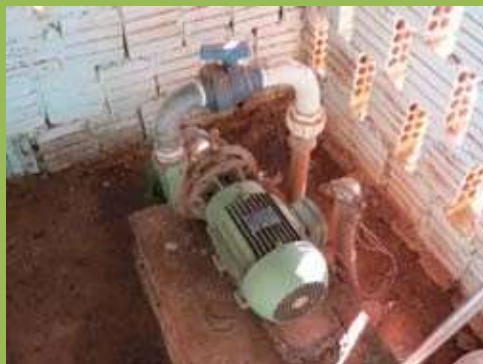
Foto 62 - Poço perfurado no Aquífero Rio Branco, em Rio Branco.
