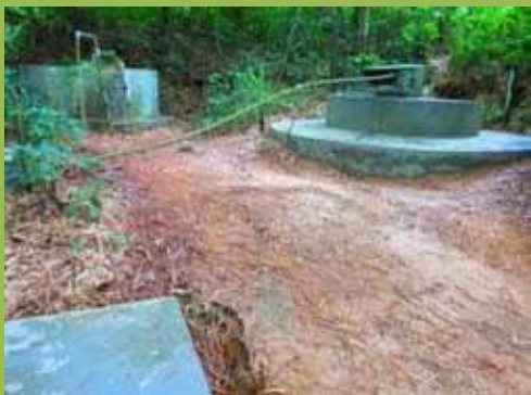
Foto 61 - Poços Amazonas - sistema de abastecimento (DEPASA), Porto Acre (sede).
