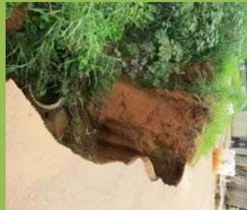
Foto 26 - Erosão em Senador Guiomard.
