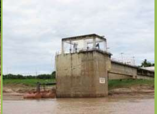
Foto 36 - Captação de água (DEPASA) no rio Acre, em Rio Branco.
