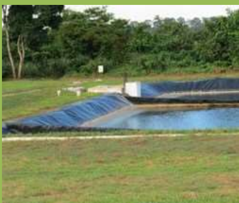
Foto 76 - UTRE - Sistema de tratamento de efluentes (chorume).
