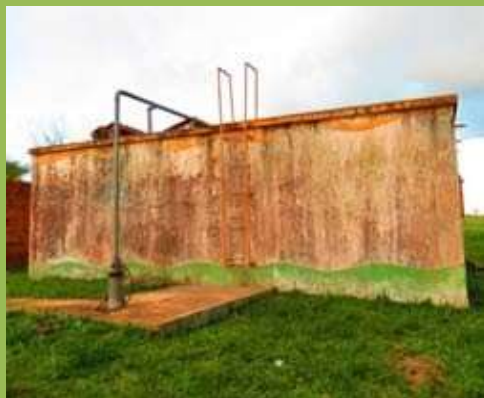
Foto 109 - Poço tubular (aquífero Solimões) e reservatório de água, bairro Corcovado, Tarauacá.
