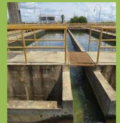
Foto 65 - ETA (DEPASA) em Rio Branco.
